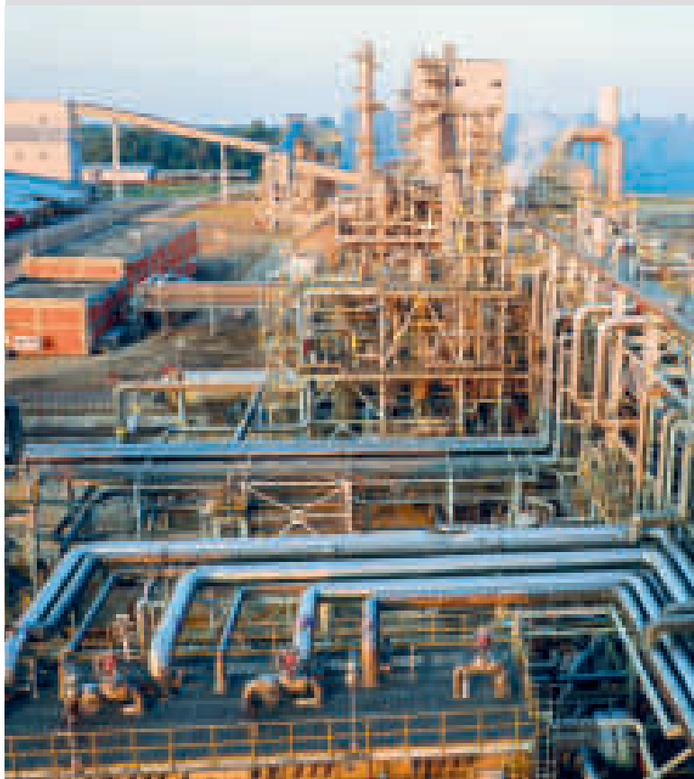
La planta de amoniaco se ubica en Bulu Bulu, municipio de Entre Ríos, Cochabamba.
