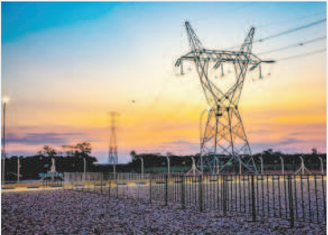
Infraestructuras de conexión eléctrica.
