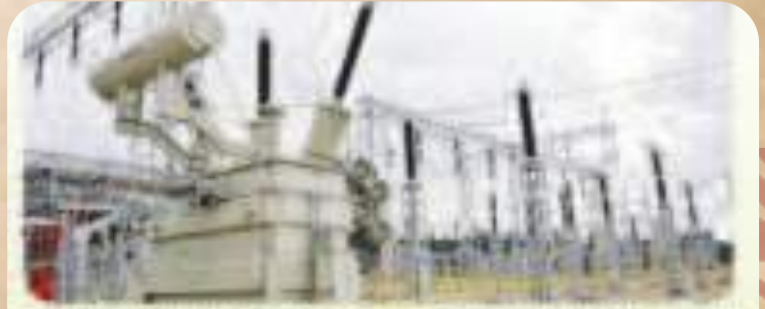
EQUIPAMIENTO PARA GENERACIÓN Y DISTRIBUCIÓN ENDE - SISTEMA COBISA. Inversión: Bs.213 millones
